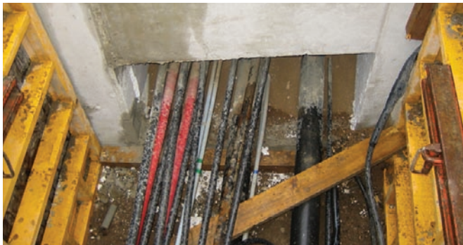
Olemasolevad nelinurksed avaused on vajalik tihendada.
